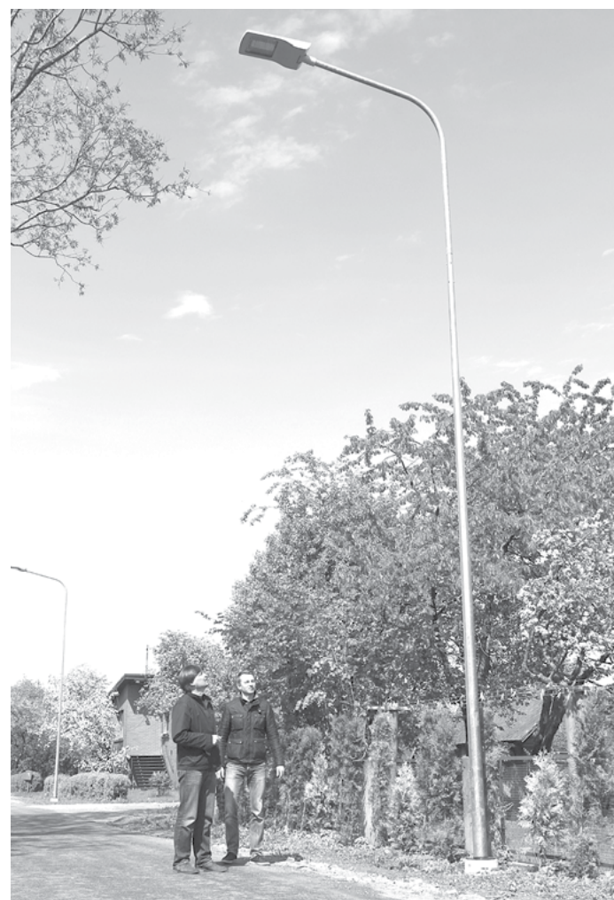
Novada domes priekšsēdētājs Dagnis Straubergs un enerģētiķis Jānis Auziņš apskata nupat uzstādītos apgaismes ķermeņus
